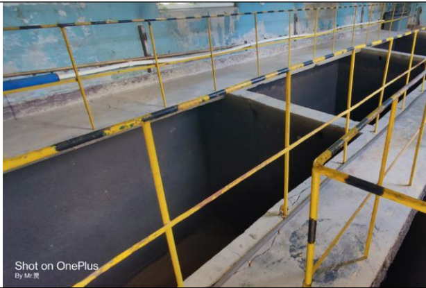
含银污泥絮凝池
