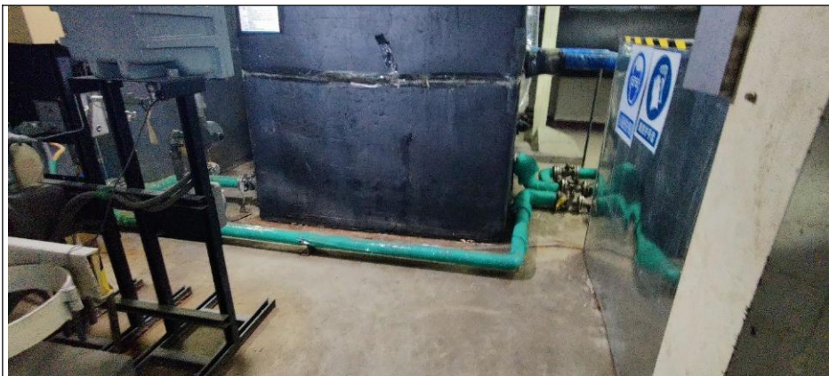
片基二部溶剂回收罐（不锈钢接地罐）
