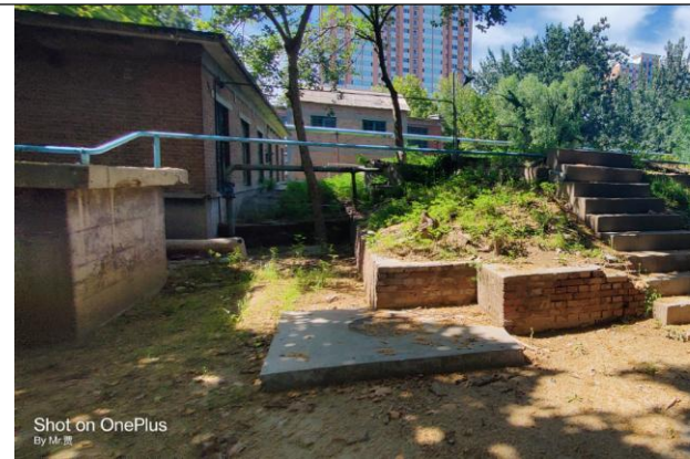
均质池（地下池体）
