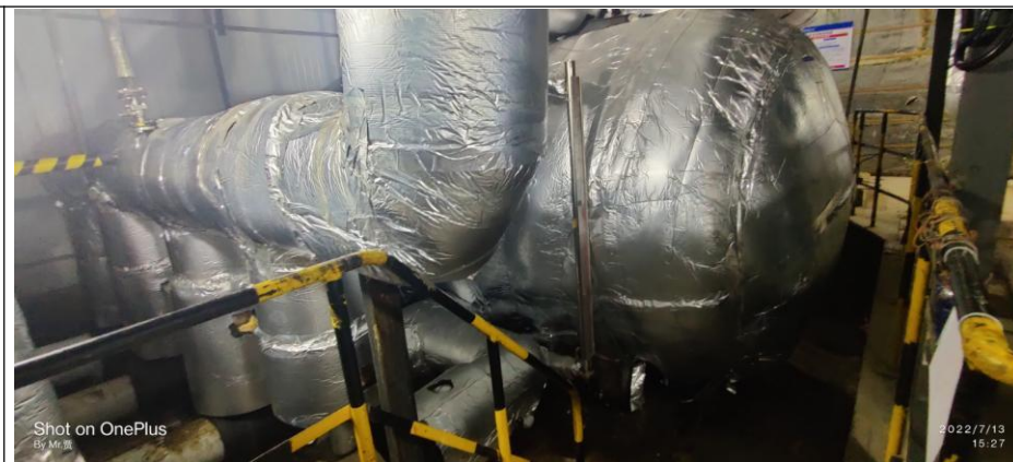
冷媒罐（位于下沉式地下室中）
