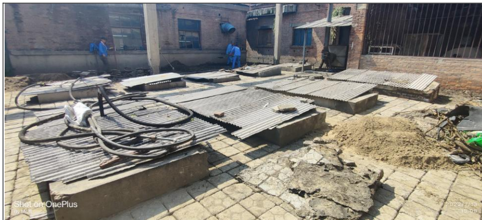
片基一部中间库地下储罐（埋深 3.0m）
