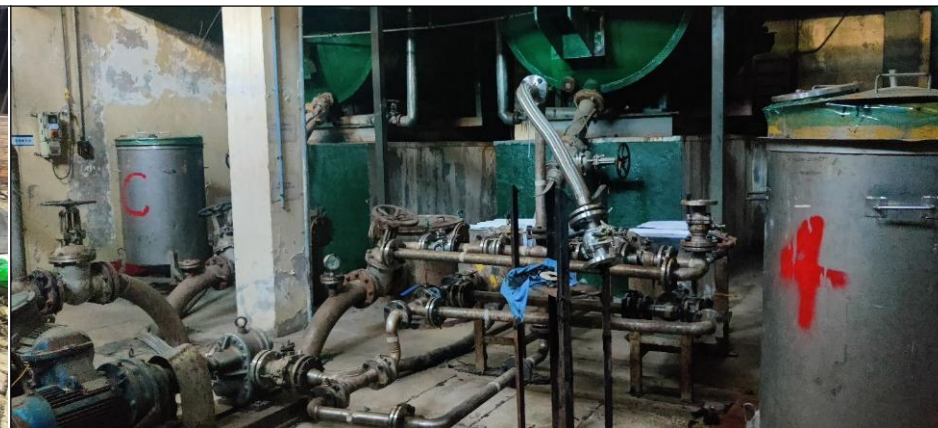
棉胶一部配制釜（架空）
