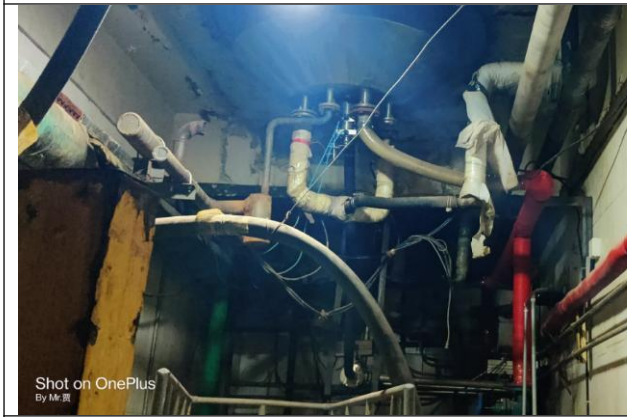
乐凯医疗乳剂车间含银乳剂配制釜（架空）
