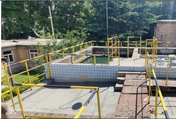
中水站曝气生物滤池
